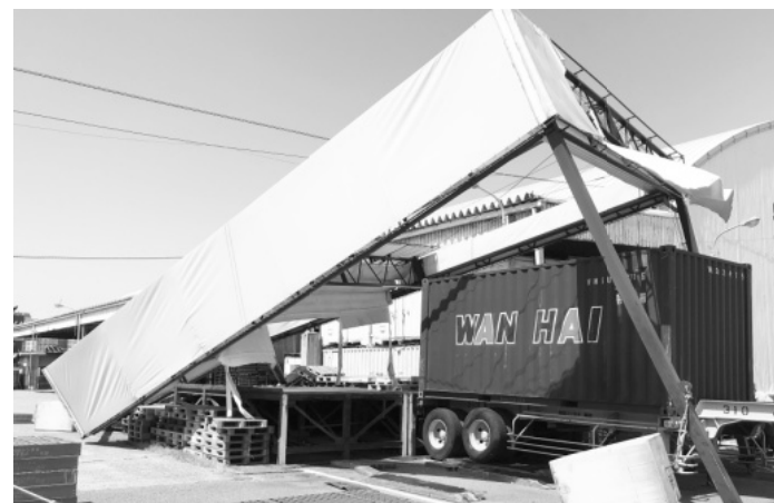
上部は吹き飛び、倒壊した倉庫テント
